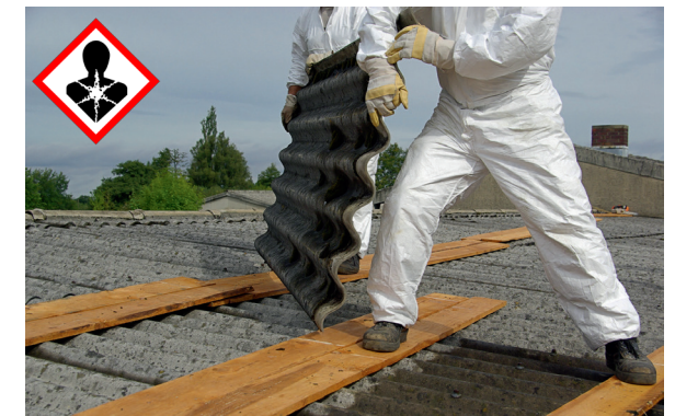
Geeignete Schutzkleidung im Umgang mit Asbest
